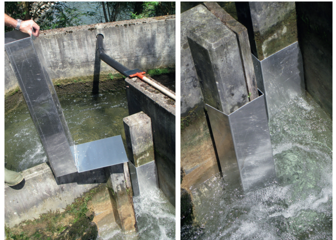
Illu. 1: exemple d'un barrage à écrevisses pour une passe à fente sur bassin à Münchenstein (BC). Selon nos connaissances actuelles, des tôles supplémentaires doivent être rajoutées sur les parois du bassin et l'angle à 90° doit être arrondi.
